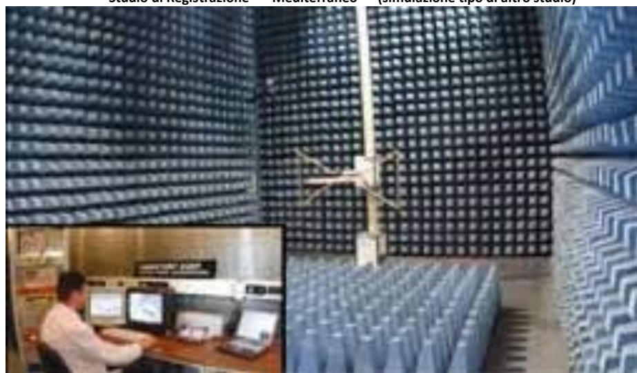
Camera Anecoica della Teseo
